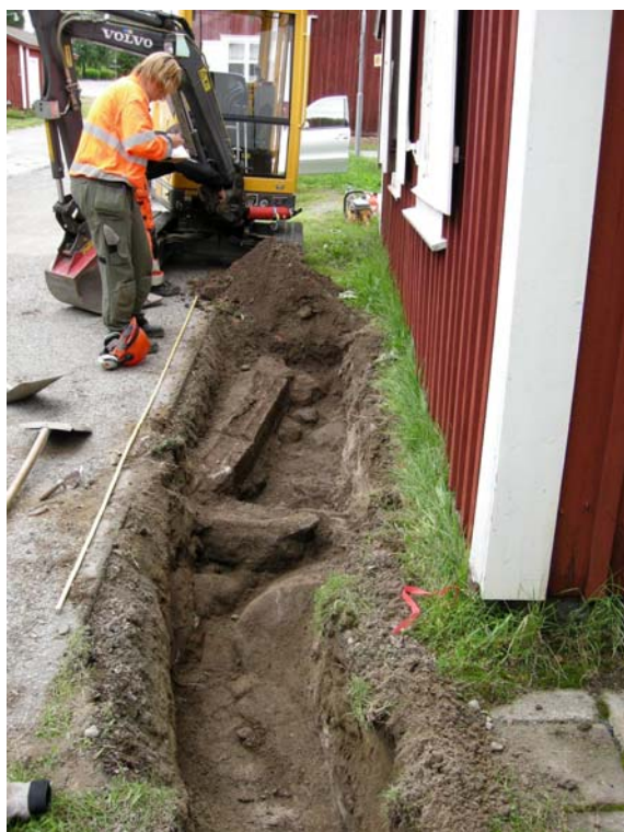
Rest av husgrund vid kyrkstuga 153 (se beskrivning föregående sida) på Organistgränd. Foto: Olof Östlund © Norrbotens museum. Nbm acc nr 2008:279:005
