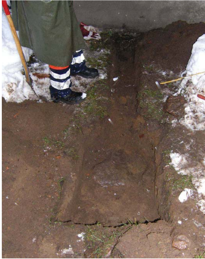
Fig 1. Ledningsschakt (längst upp i bild) och schakt för borrhål. Nivå 0,25-0,30 m. Från NÖ. Högst upp i bild syns NÖ husväggen av Gamla Hamngatan 1. (Acc.nr: Nbm 2006:392:1) © Norrbottens Museum
